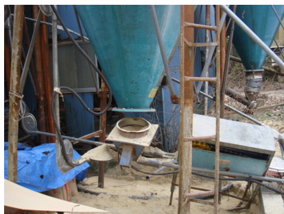
農場全部のタンク下部が破損
