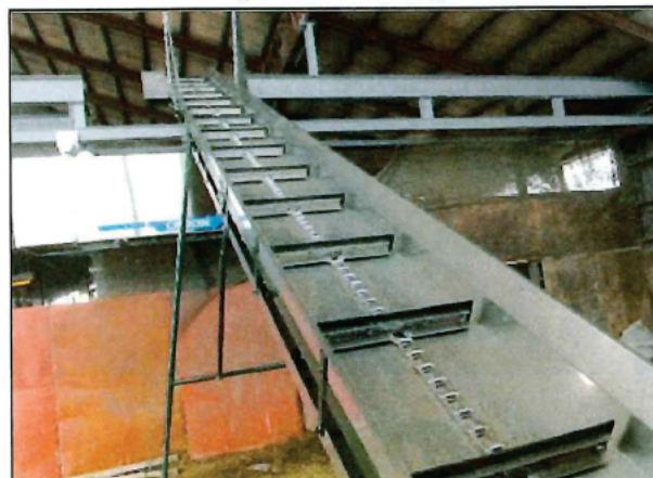
【エレベーター】
