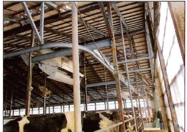
【敷料散布機ガイドレール（H鋼）】
