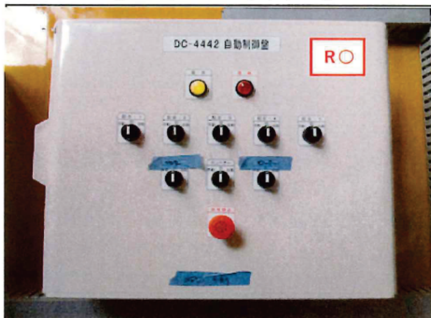
【コントロールボックス】
