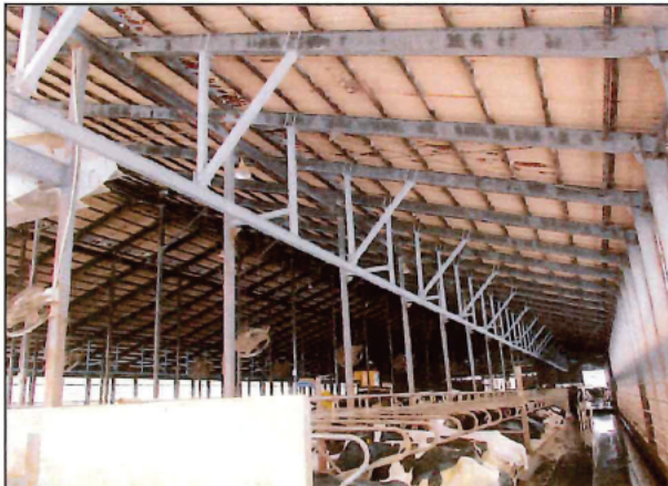
【敷料散布機ガイドレール（H鋼）】
