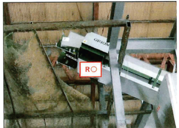
【エレベーター】
