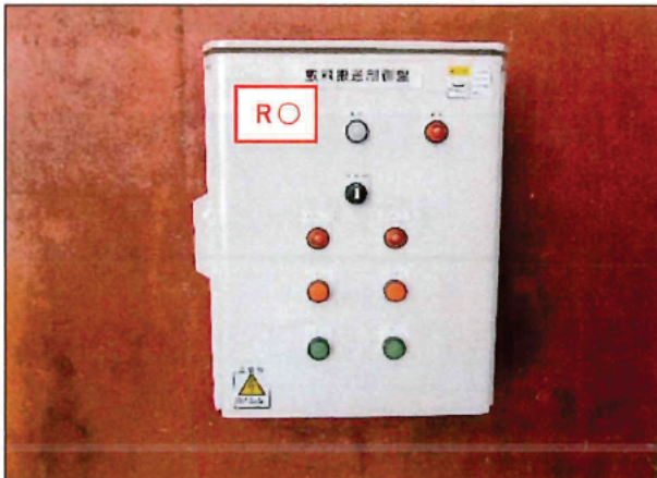
【敷料散布機制御盤】
