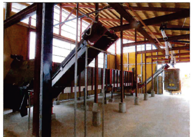
【自動給餌機・コンベアー設置状況】
