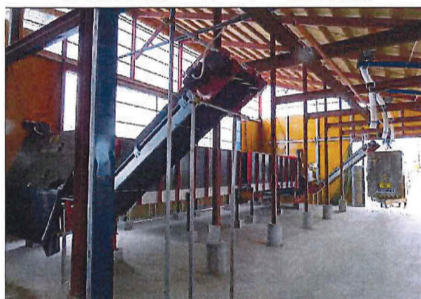
【自動給餌機・コンベアー設置状況】
