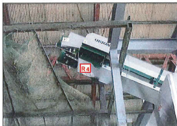
【サイレージエレベーター】
