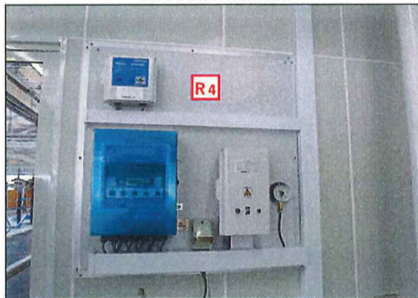
【洗浄装置制御盤】
