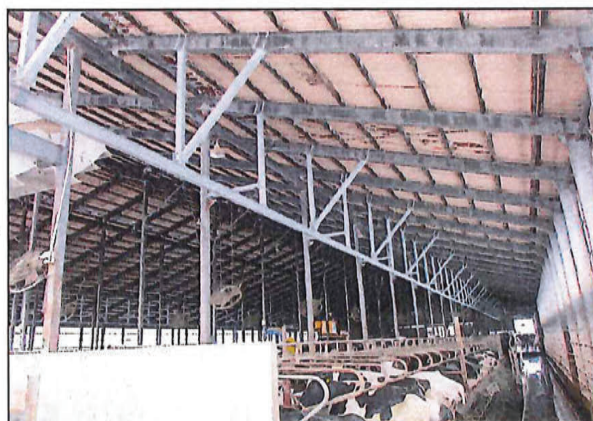
【敷料散布機ガイドレール（H鋼）】
