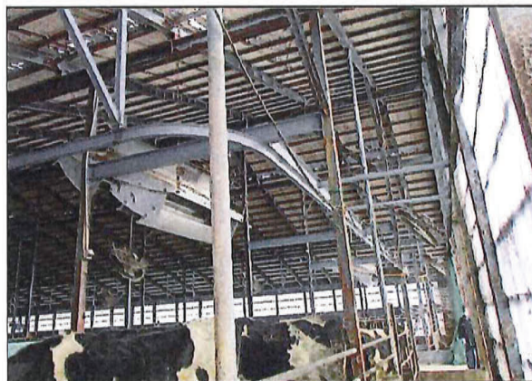
【敷料散布機ガイドレール（H鋼）】
