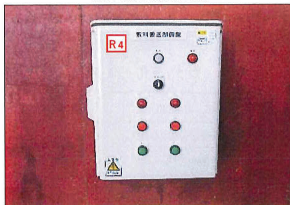
【敷料散布機制御盤】
