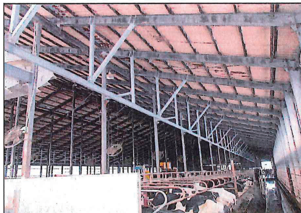
【敷料散布機ガイドレール（H鋼）】
