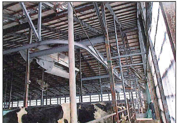
【敷料散布機ガイドレール（H鋼）】
