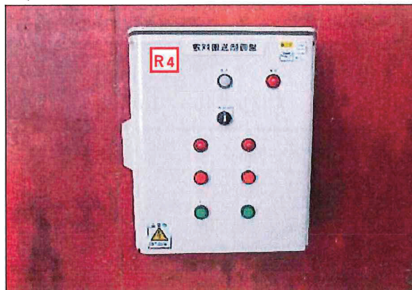
【敷料散布機制御盤】
