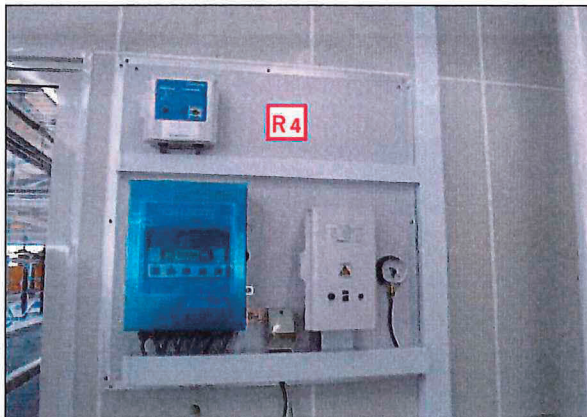
【洗浄装置制御盤】
