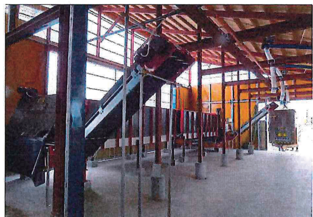
【自動給餌機・コンベアー設置状況】
