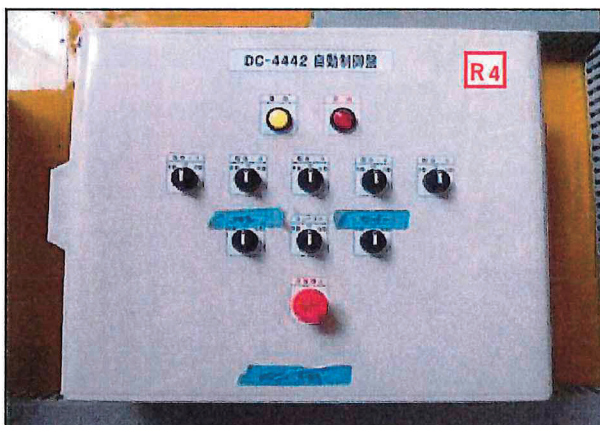
【コントロールボックス】
