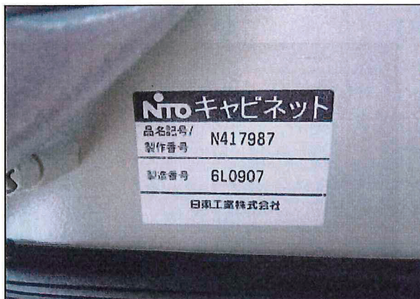
【操作盤キャビネット（製造番号：6L0907）】
