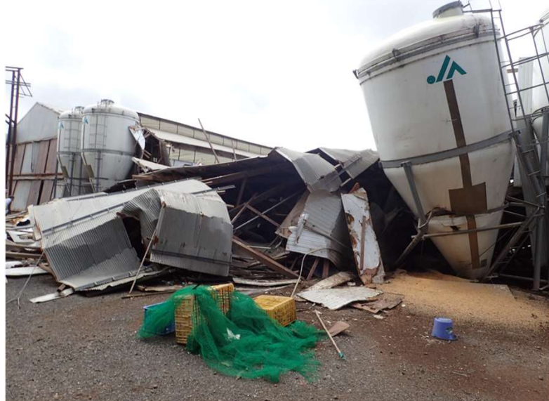
畜舎倒壊の様子
