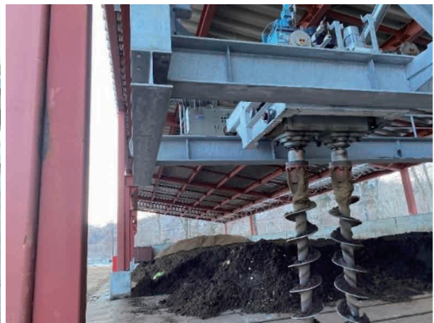
スクリー式堆肥攪拌装置 (令和4年導入)
