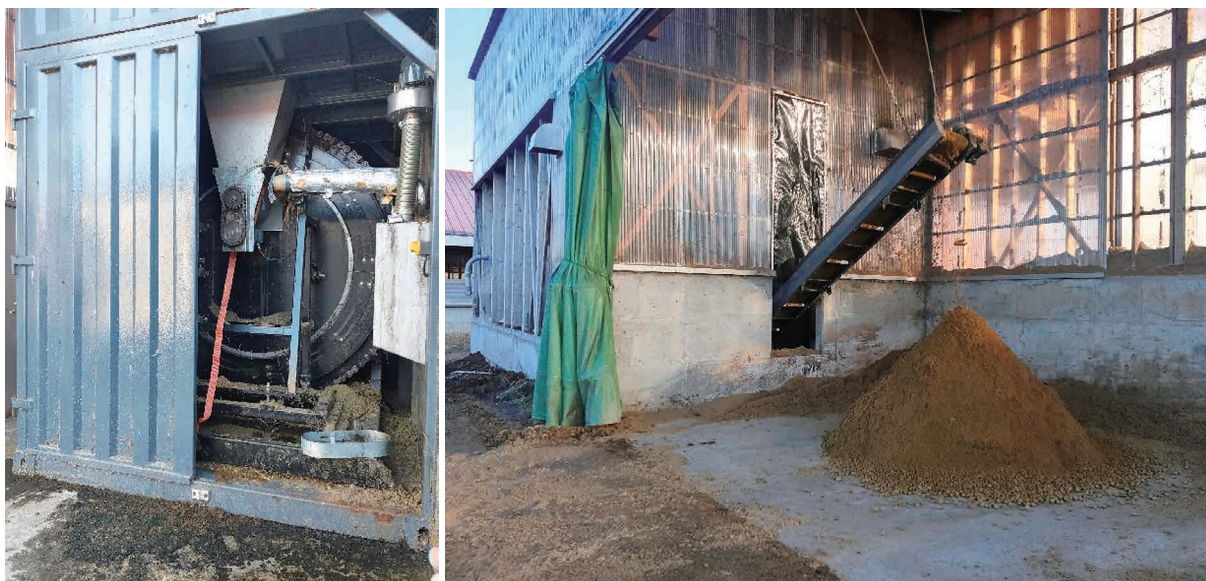
コンポスター堆肥舎 24 時間で堆肥化を行う
