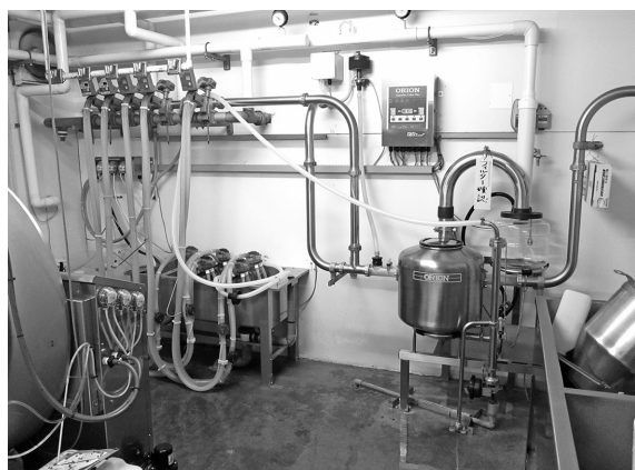
(写真9) 清潔に管理されたミルクシステム処理室
