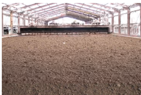
発酵乾燥施設によるたい肥化処理
