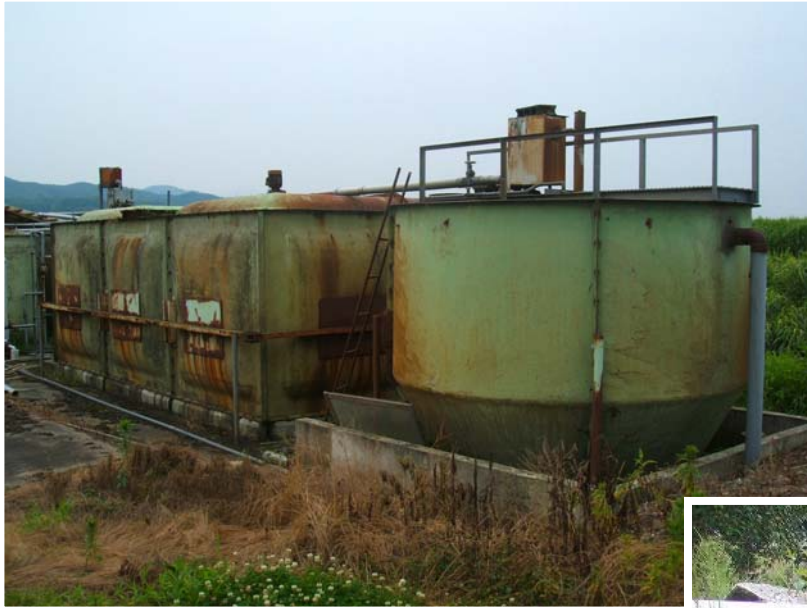
くみあい浄化槽
