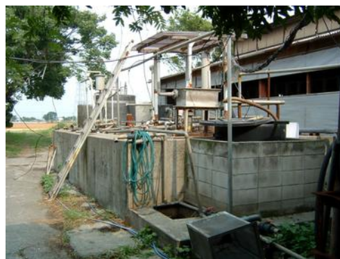
尿浄化処理施設
