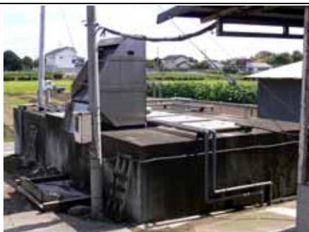
浄化処理施設
