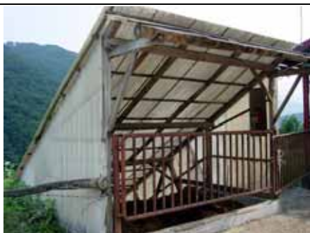
傾斜地を利用した、ふん投入口
