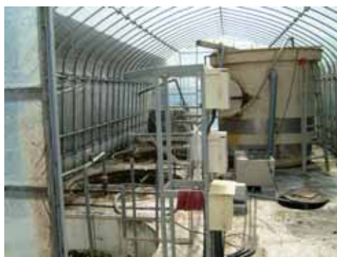
パラーの汚水も浄化処理して放流
