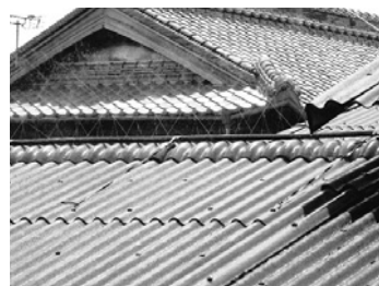
写真3：屋根散水の状況
