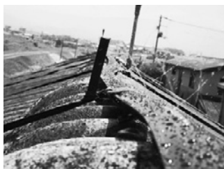
写真2：屋根中央に固定した散水チューブの状況
