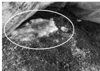
(写真1) 発生したカビ
