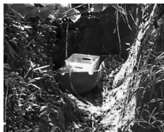
ドラム缶(プラスチック製)を利用した貯水タンク
