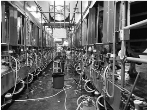
パーラー施設内
