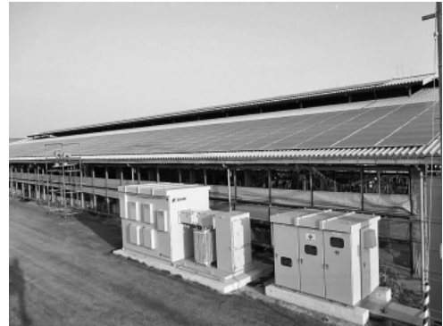
太陽光パネルを設置している
