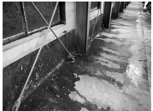
(写真2) 結露した壁面
