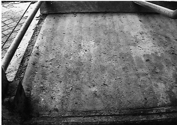
(写真5) 消毒前の状態
