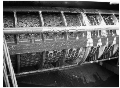
写真1 固液分離機（スクリュープレス）による脱水
