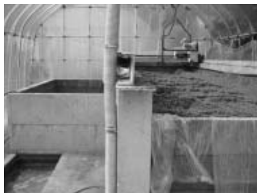
オガクズろ床による尿汚水ろ過装置内部
