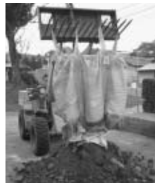
（写真3）底部排出口の開口
