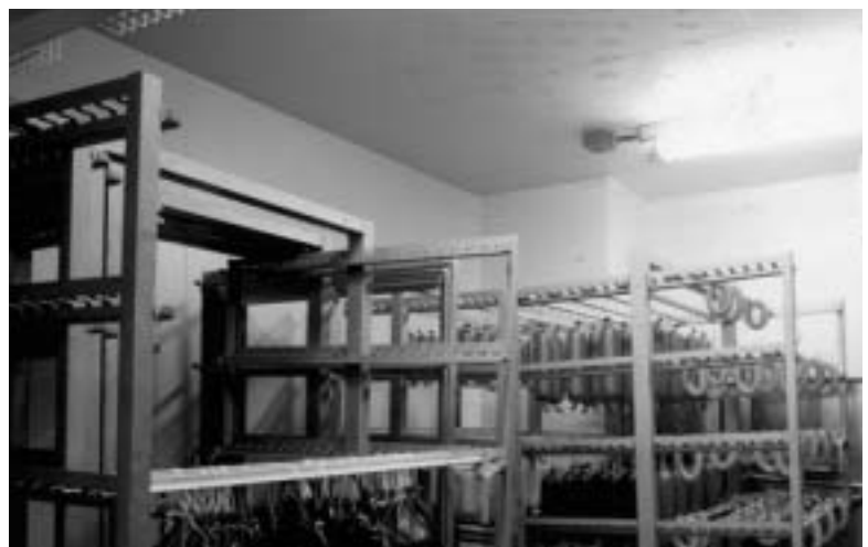
(写真2) 施設内冷却庫
