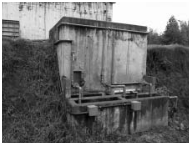
写真 - 3 ろ過装置外観
