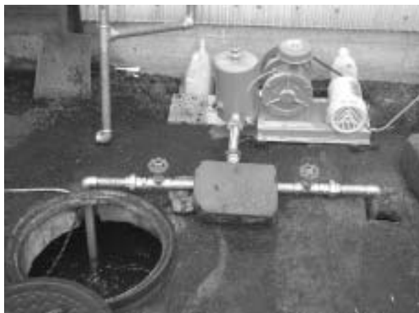
写真-2 設置したブロワー（2槽に分かれている）
