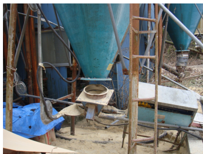
農場全部のタンク下部が破損
