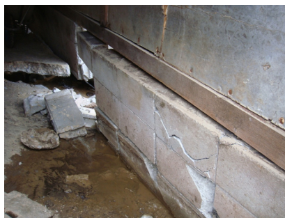
飲水用の配管が破損
