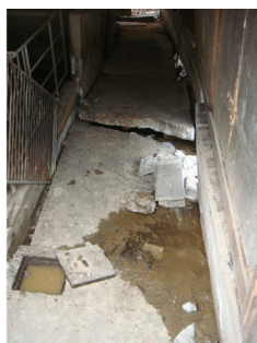
水道管が破損し、母豚が飲水が出来ない状態
