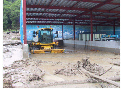
機械庫も土砂が流入し、50cmほど堆積した
