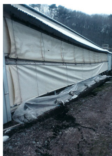
川俣町の被害豚舎
