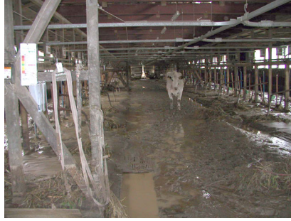
土砂が流入した牛舎内部
