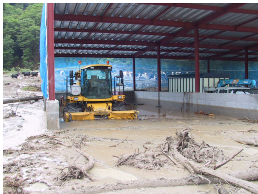
機械車も土砂が流入し、50cmほど堆積した
