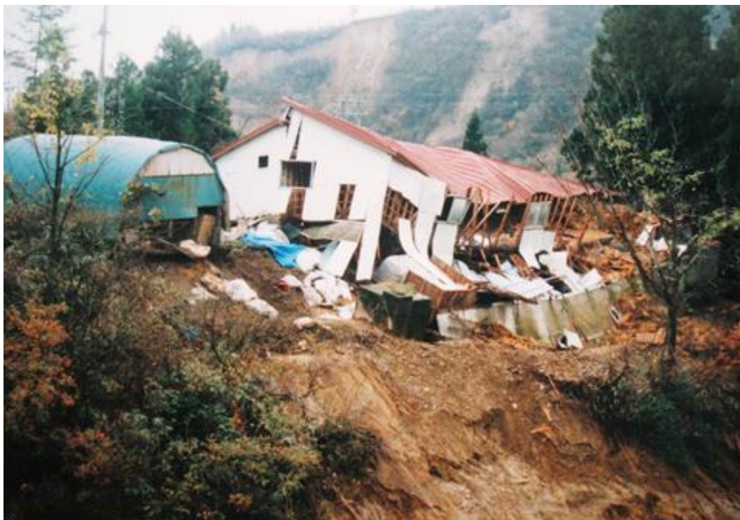
我が家の倒壊した牛舎
