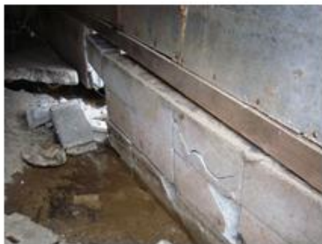
飲水用の配管が破損
