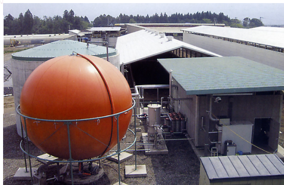
バイオマスセンターのメタン発生装置
