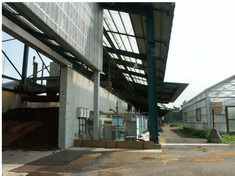
写真6. 堆肥発酵槽(左)、簡易スクラバ(中央)および廃熱利用ハウス(右)
