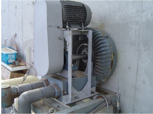
写真3. 吸引通気用に改良した渦流送風機
