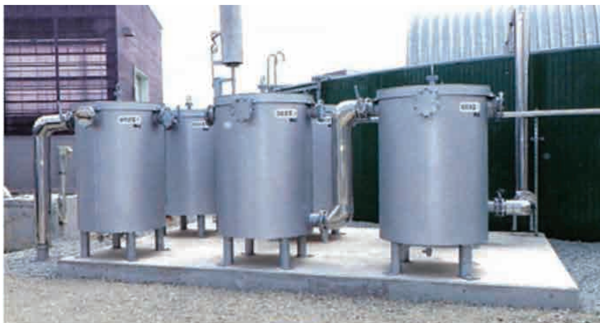
5. 脱硫設備 余剰ガス燃焼装置
