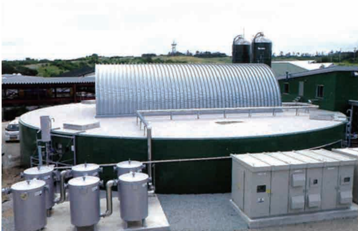
4. 発酵槽 ガスホルダー キュービクル
